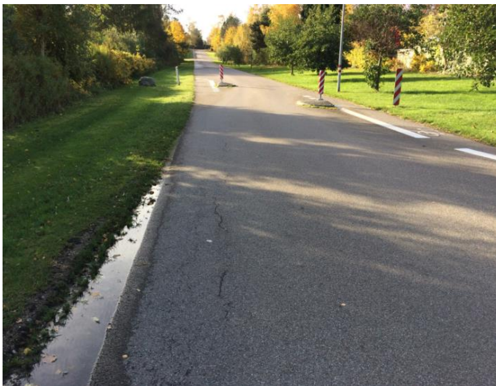
Foto 3: Revner og krakeleringer ved chikanerne. Bemærk, at rabatten også opkøres, øjensynligt af store køretøjer, som har sværere ved at manøvrere igennem chikanen.
