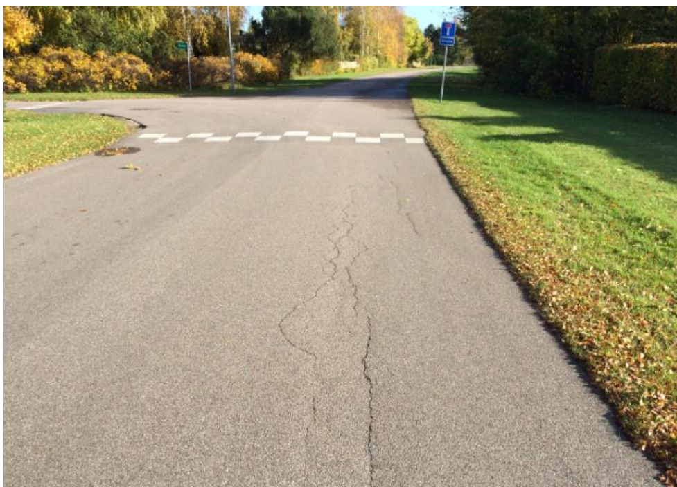
Foto 7: Krakeleringer og sporkøring på den østlige ende af Fuglevangen, ud for indkørslen til Blåmejsevej, hvor rensningsanlægget er placeret.
