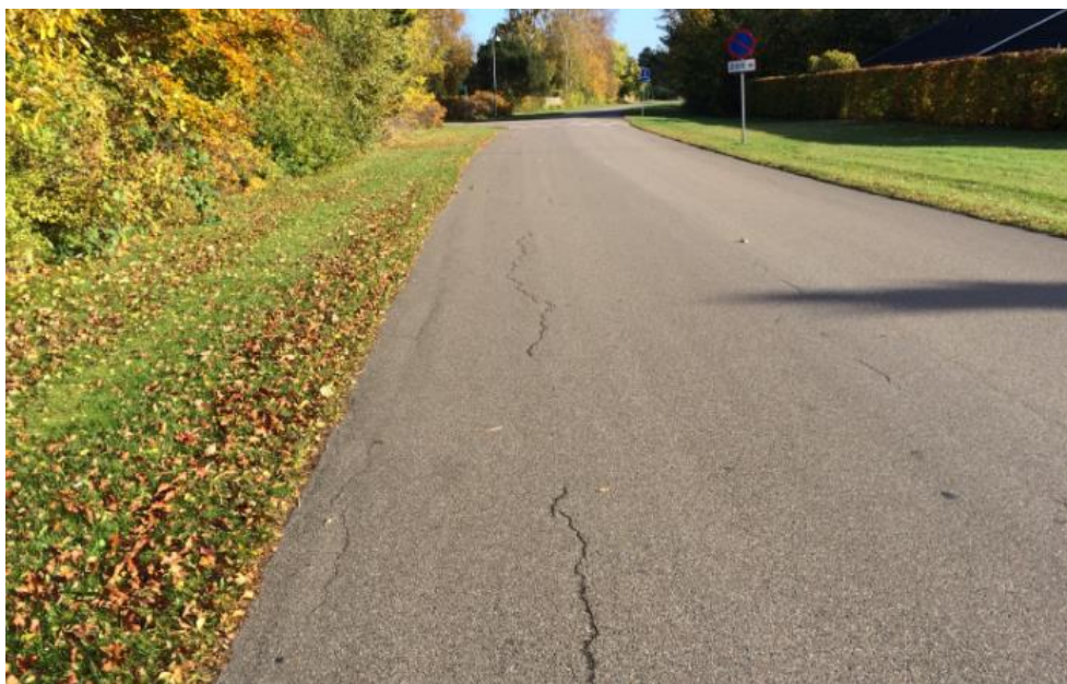
Foto 6: Hyppige krakeleringer og langsgående revner. Bemærk endvidere, at vejens midtersamling på store dele af strækningen er revnet.
