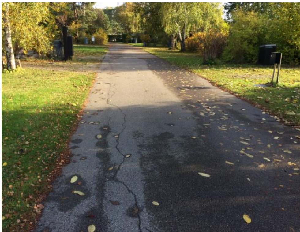
Foto 8: Revner på Blåmejsevej.
