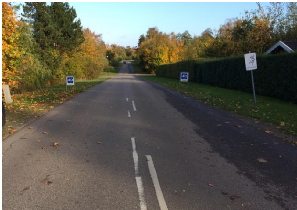
Foto 1: Fuglevangen set fra Vingerødvej mod øst. Den første højere liggende del af vejen synes knap så nedbrudt. Bemærk dog den generelle langsgående krakelering i vejens venstre side (forårsaget af udadgående trafik).
