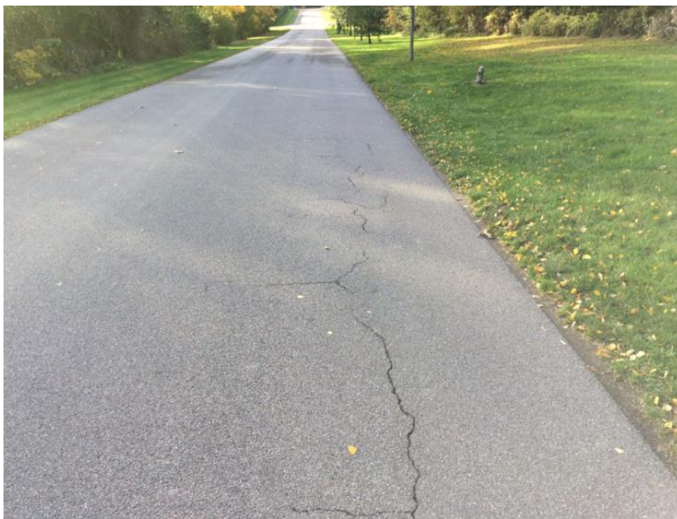
Foto 4: Langsgående revner og krakeleringer forekommer i stort omfang på vejen. Bemærk også de systematiske tværgående revner, som kunne tolkes som begyndende svindrevner grundet den gamle asfalts hårdhed, som er så sprød, at den er følsom for trafikbelastningen
