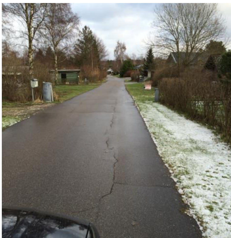
Foto 2: Stikvej på Fasanvej: Samme systematisk forekommende, alvorlige tværgående svindrevner i asfaltbelægningen og langsgående revne, som formodentlig er en gennemslagsrevne fra en tidligere udført sideudvidelse af vejbelægningen. Desuden ses i mindre omfang skader i vejens yderside som følge af bæreevnesvigt.
