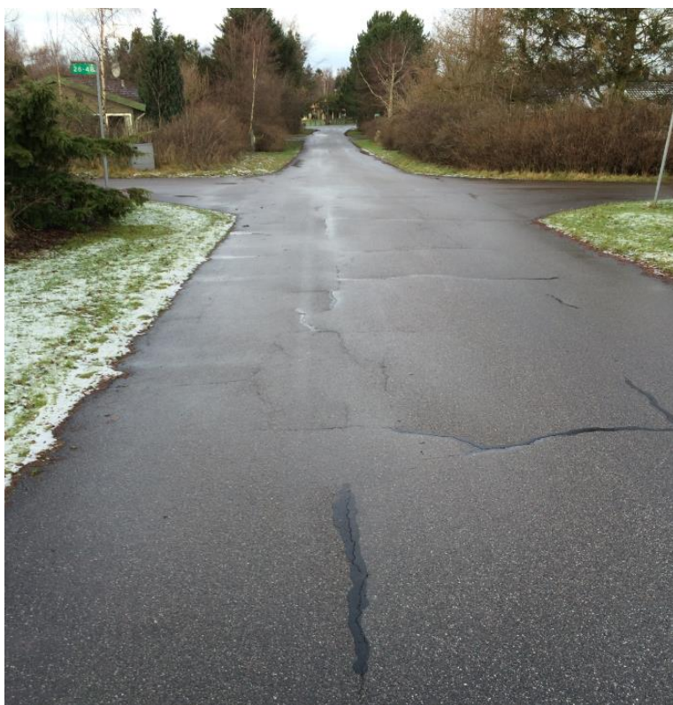
Foto 3: Stamvejen på Fasanvej: Samme systematisk forekommende, alvorlige tværgående svindrevner i asfaltbelægningen. Revnerne er her suppleret med langsgående revner, som sandsynligvis stammer fra en ældre sideudvidelse af vejens bredde.
