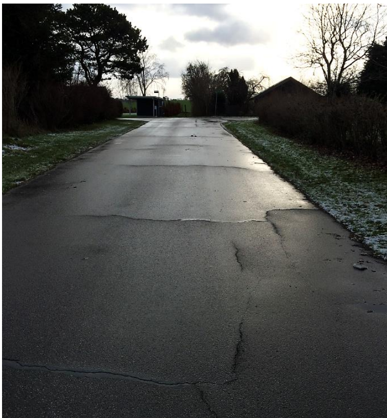
Foto 4: Stamvejen på Fasanvej: I modlys ses revnerne endnu tydeligere. De opståede svindrevner lader regnvand trække ned i belægningen, hvorefter der i frostvejr sker opfrysninger, så vejen "bølger" hen over revnerne. I vinterperioder med hyppige frost/tøskift nedbrydes belægningen hurtigt.
