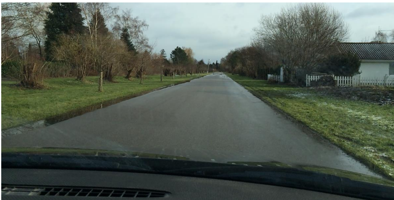
Foto 9: Belægningen på fordelingsvejen Fuglevangen er i rimelig tilstand – enkelte steder konstateres dog skader, som tydeligvis er forårsaget af tung trafik. Fuglevangen fungerer samtidigt som tilkørselsvej for det lokale rensningsanlæg og udsættes derfor for mere trafikpåvirkning end boligvejene i sommerhusområdet. Endvidere er der gennem Fuglevangen via Duevej i nord åben forbindelse for gennemkørende trafik til naboudstyknngen.
