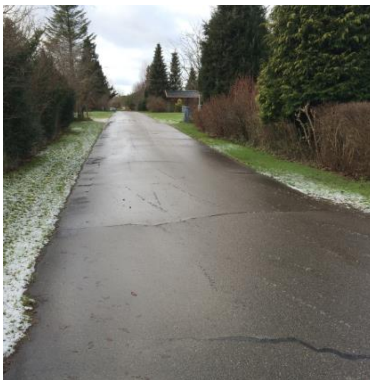
Foto 1: Stikvej på Fasanvej: Systematisk forekommende, alvorlige tværgående svindrevner i asfaltbelægningen. Desuden ses i mindre omfang skader i vejens yderside som følge af bæreevnesvigt.
